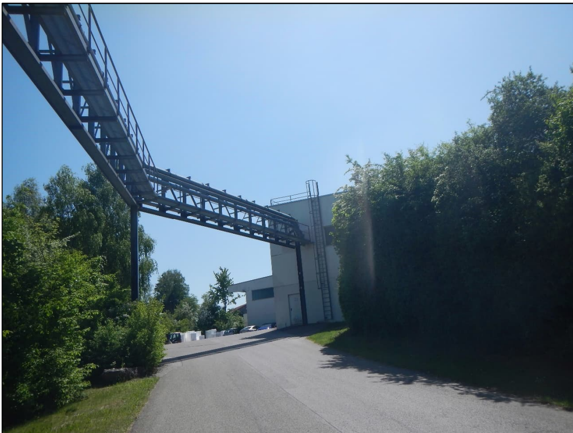
Abbildung 11: Foto der oberirdischen Granulattransportleitung /22/
